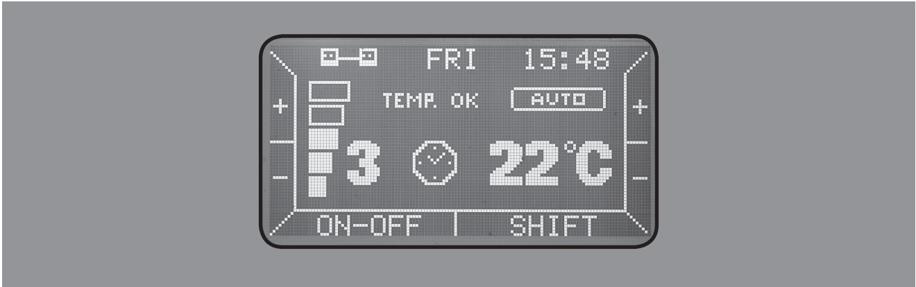
Abb. 11: Display-Anzeige bei Automatikbetrieb
